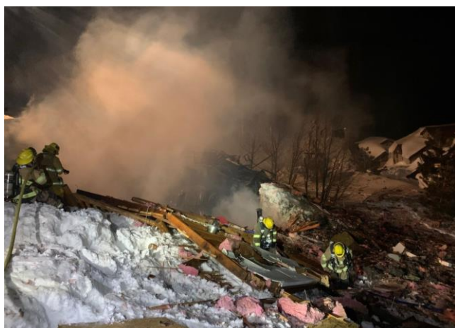
Figura 8: El MLFPD responde a la explosión estructural en Juniper Road.
